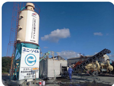
造粒固化施設
