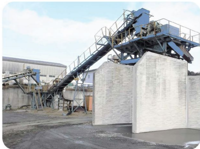
がれき類の破碎施設 小割機
